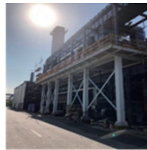
生物滴滤+活性炭吸附+RCO
